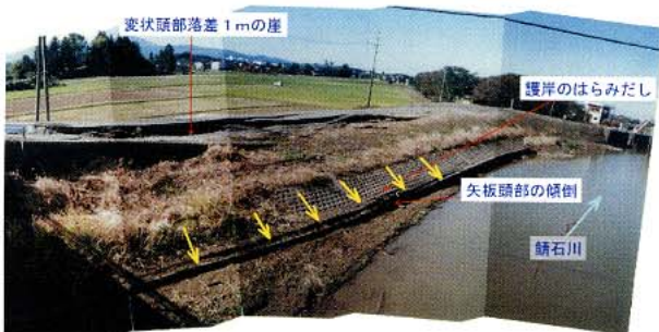
写真12 堤防変状状況の例(新潟県柏崎地域振興局提供)
