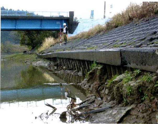
写真13 矢板(軽量矢板)護岸の傾倒状況(新潟県柏崎地域振興局提供)
