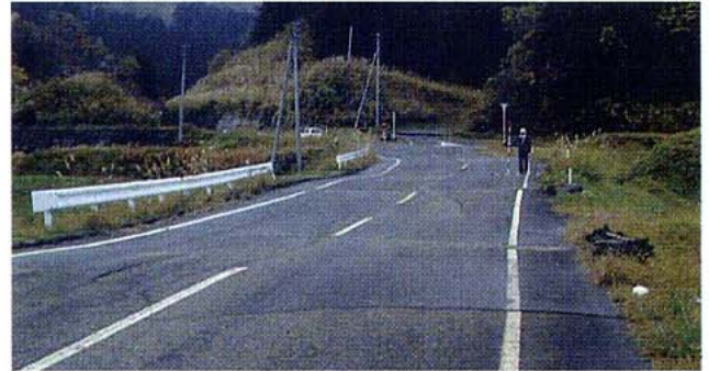
写真9 所々陥没して波をうったような道路
